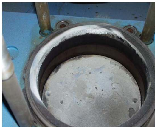
Siliziumdioxid-Ablagerungen an Zylinder und Ventil eines mit Klärgas betriebenen BHKW
